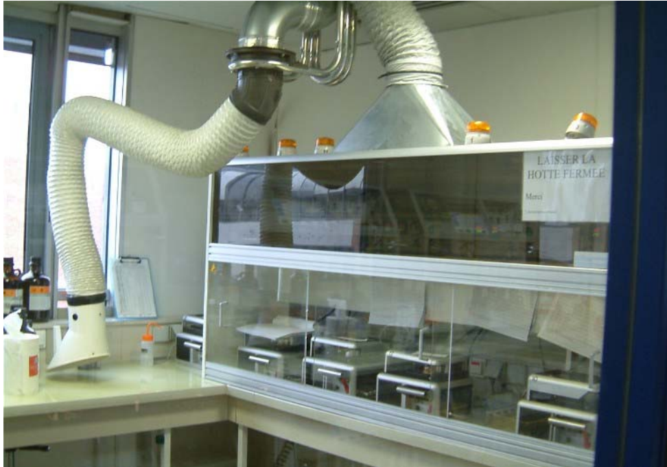
Photo 1 : Les cuves d'ammoniac sont placées dans une sorbonne fermée.
